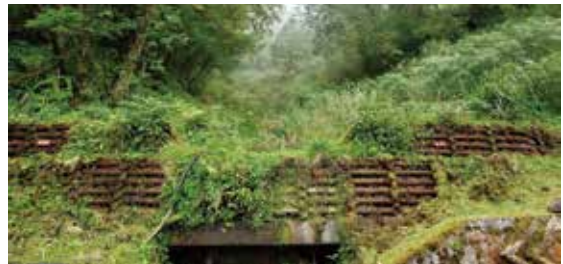
■ 宜專一線 16.5K 木構節制壩 2025 年現況
