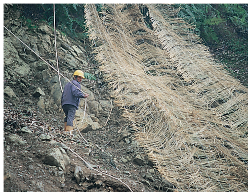
國有林崩塌地整治
