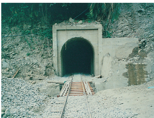
(上) 90年7月桃芝颱風造成花蓮大興地區嚴重土石流災害。
