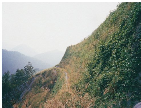
(中)奧萬大林道921地震造成下邊坡崩塌情形
