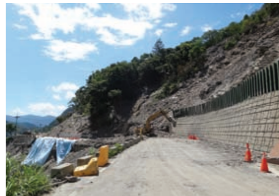
▲南投處－奧萬大聯外道路7K+000工程改善前情形
