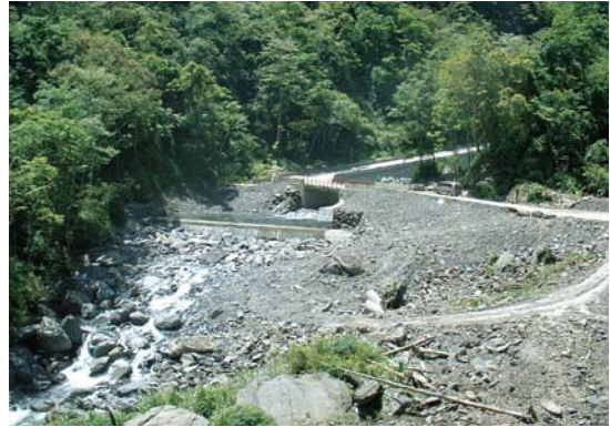
▲大鹿林道9K護岸橋台基礎加固工程改善後情形／林志明 攝
