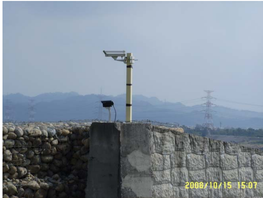
圖 15 西口影像監視器新架設位置（2008/10/15）
