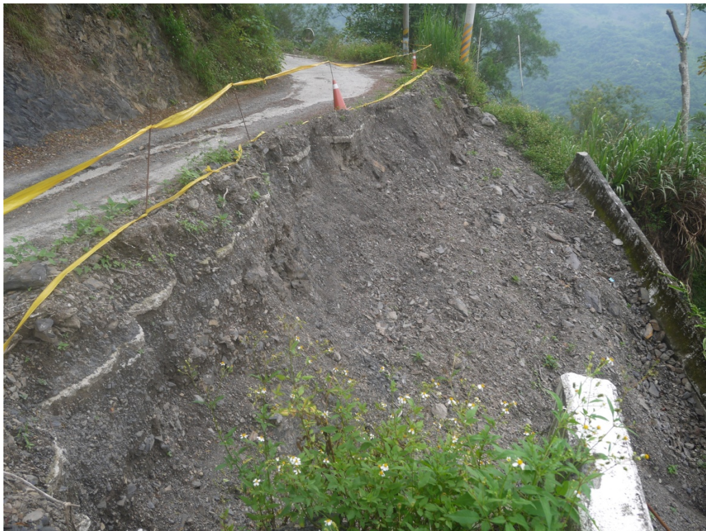
照片 3-4.15、調查點 6 下邊坡滑移，路面毀壞。
