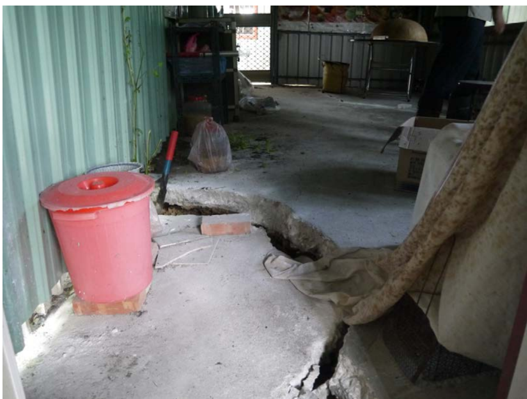
照片 3-4.33、調查點 G7-1 坡頂建物拉張，高差 20 公分。
