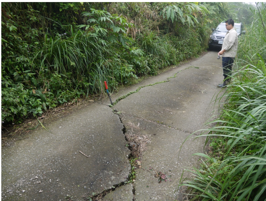
照片 3-4.38、調查點 G7-6 邊界裂隙通過路面，導致路面毀壞。
