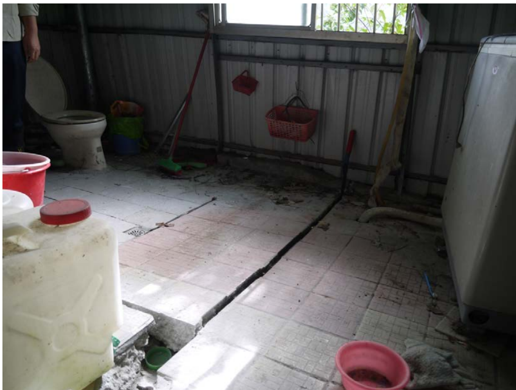
照片 3-4.32、調查點 G7-1 坡頂建物地板已拉張破壞，寬度約 5 公分。
