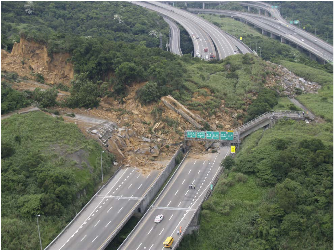
圖 2-4.7、國道三號順向坡平面型破壞照片(網路照片)。
