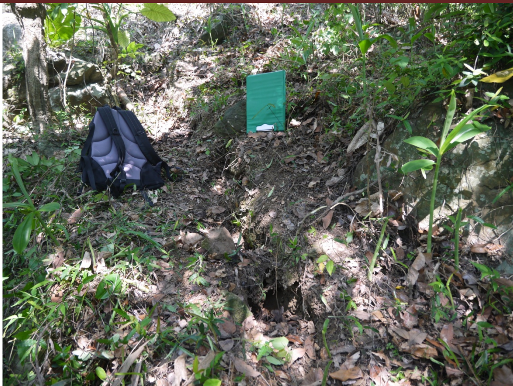
照片 3-4.53、調查點 08 位於南側崩塌坡腹，此裂隙高差約 20 公分。
