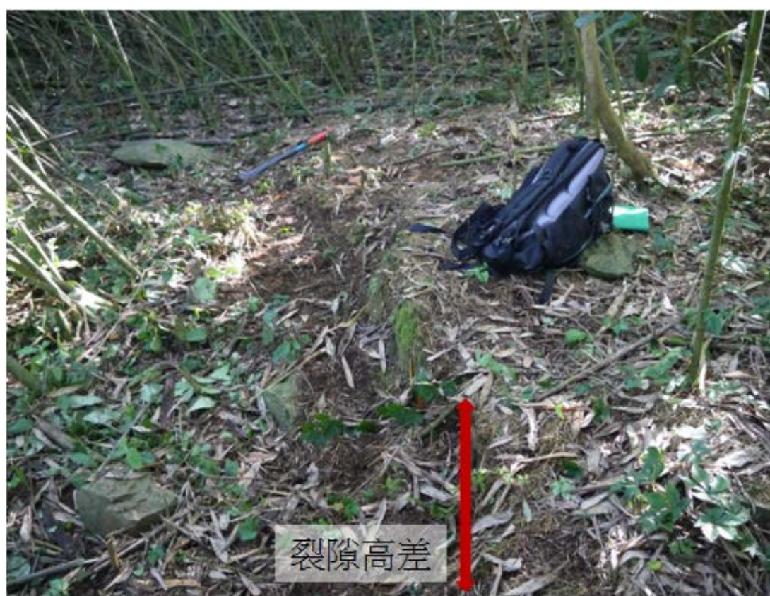
照片 3-4.42、調查點 G6-6 北側主崩崖內部發育一高差 20 公分裂隙。
