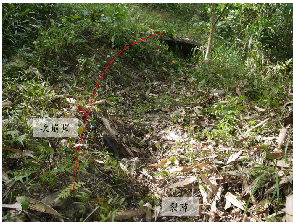
附錄照片 5、調查點 02 坡腹次崩崖通過農路，使其路基流失。
