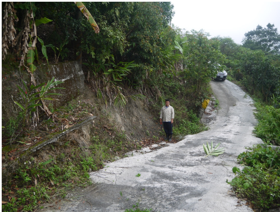
照片 3-4.69、調查點 3 位於坡腹之道路與擋土牆破壞情形，舊有道路路面與現今路面落差約 2 公尺。
