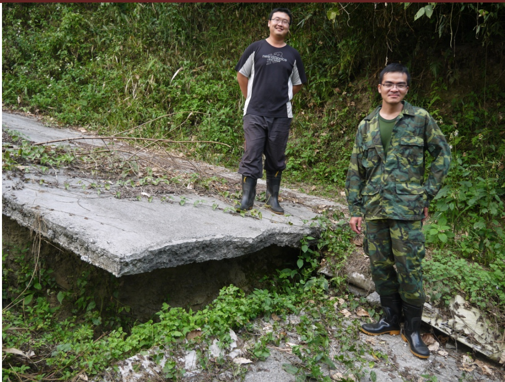
照片 3-4.12、調查點 19 因冠部裂隙拉張導致路面有近 50 公分的落差。
