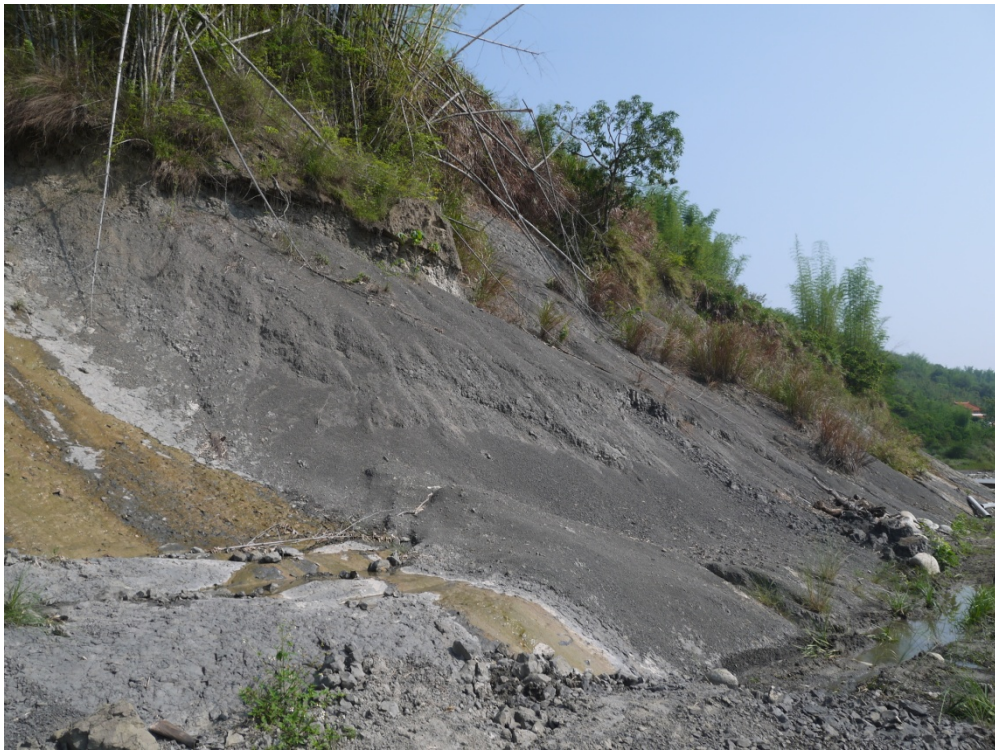
照片 3-4.47、崩塌地編號高雄高雄市-甲仙區-D044 趾部為鹽水坑頁岩，岩性較為軟弱，地形常為緩坡或低矮區。
