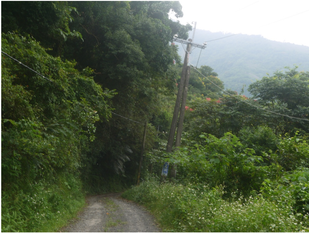
照片 3-4.14、調查點 5 位於崩塌南側坡面，現地電線桿已有傾斜的跡象。
