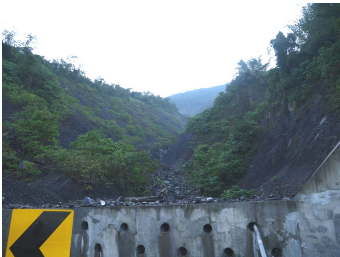
照片 3-4.44、調查點 G6-1 崩塌地北側土石流出口，坡趾主要為崩積層。
