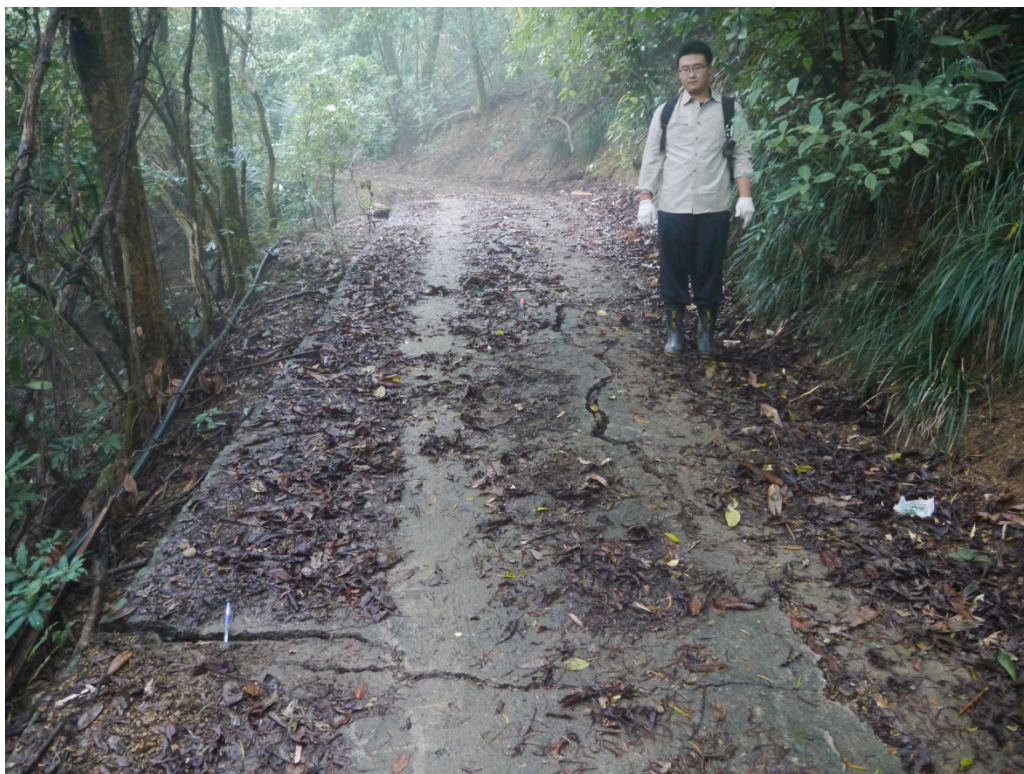
照片 3-4.25、調查點 G4-11 崩塌邊界路面毀壞。
