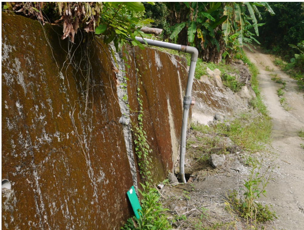
照片 3-4.71、調查點 5 位於坡腹因坡體滑動，導致道路和擋土牆損壞。
