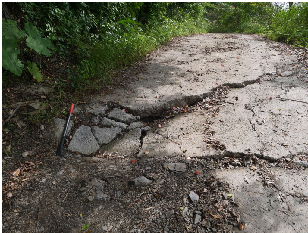
照片 3-4.13、調查點 1 因邊坡滑移導致路面有 20 公分的落差。
