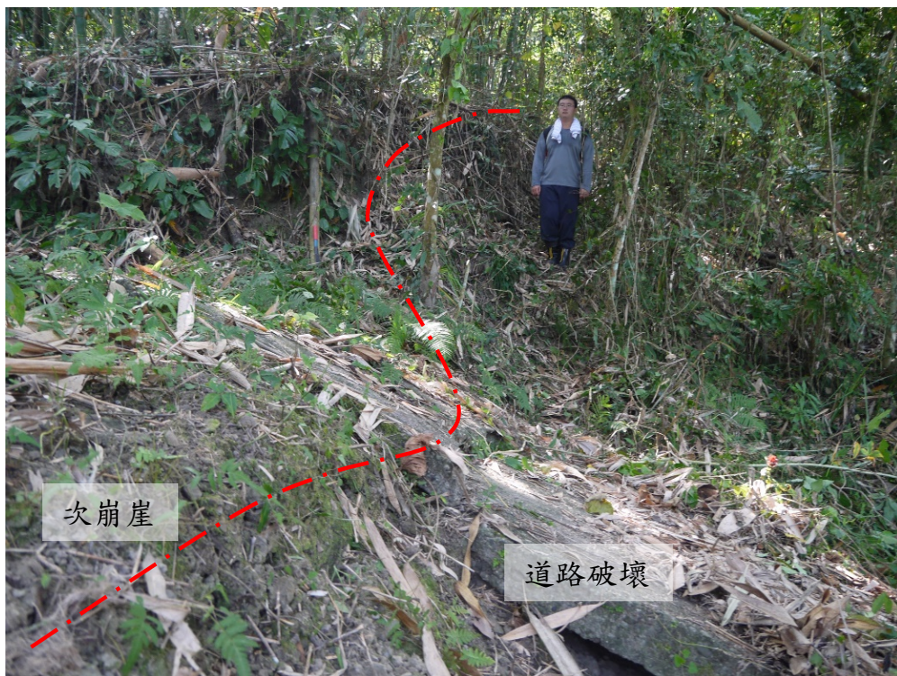
附錄照片 6、調查點 03 坡腹次崩崖垂直通過農路破壞，此破壞面和崩崖面方向一致。
