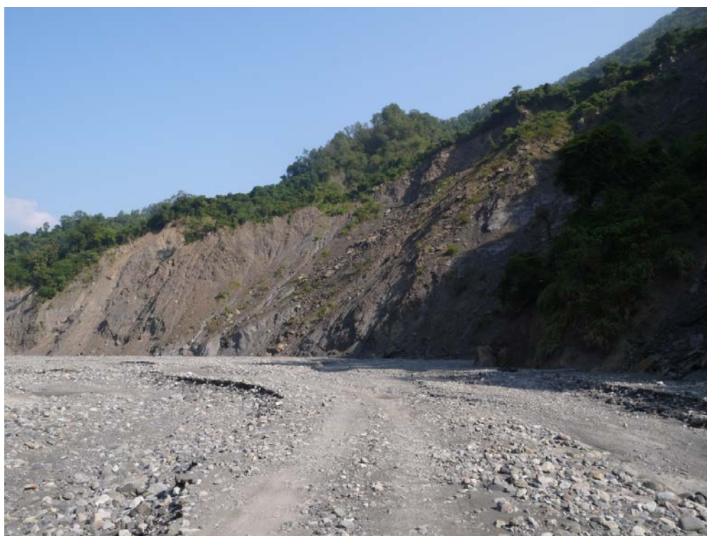
照片 3-4.1、崩塌地編號高雄市-桃源區-D346 趾部崩塌。崩積層厚度近 10 公尺。
