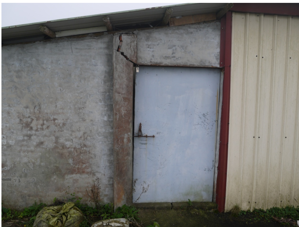
照 3-4.37、調查點 G7-5 冠部崩崖發育，導致建物拉張毀壞。
