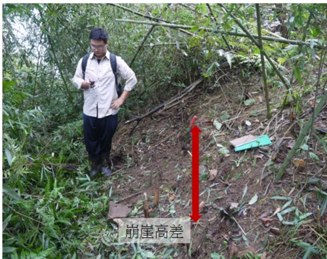
照片 3-4.40、調查點 G6-3 深層崩塌地編號高雄市-六龜區-D015 冠部崩崖，崩崖高差 1 公尺。
