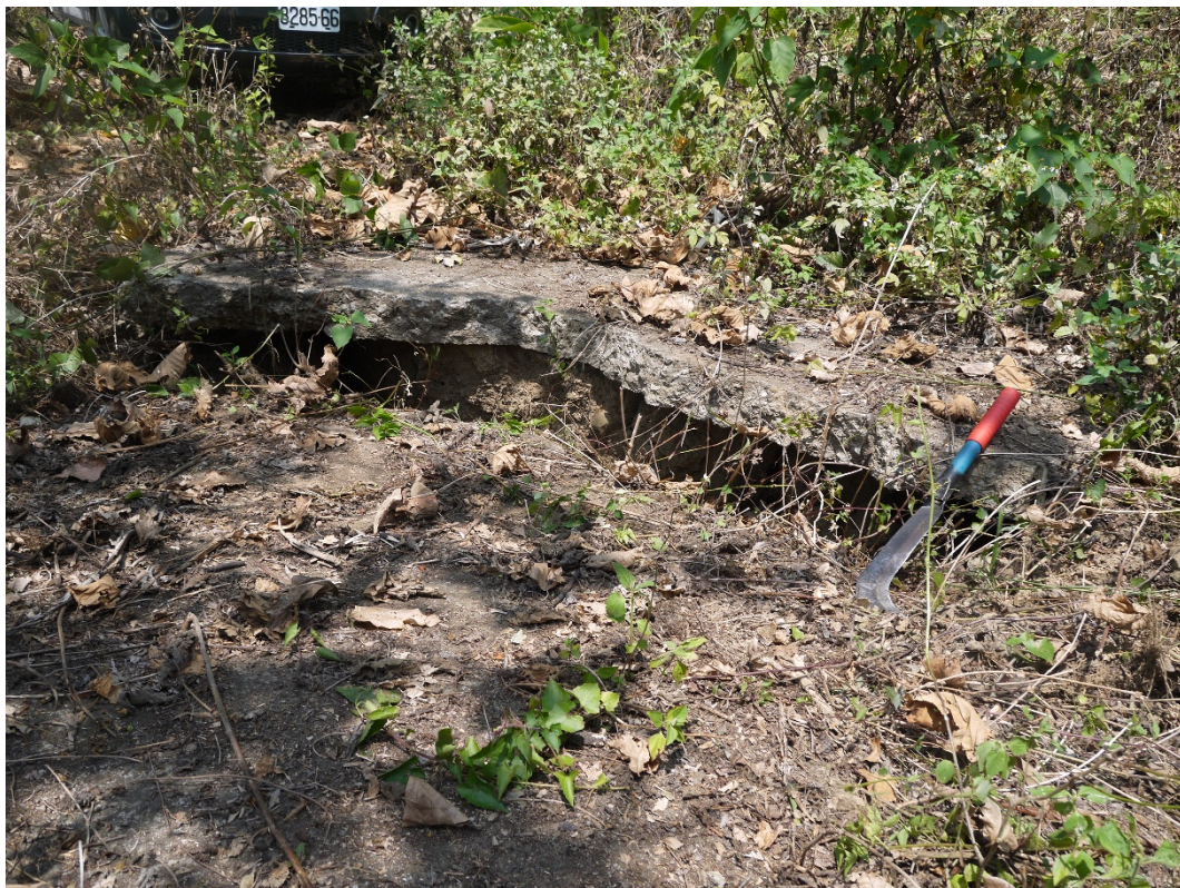
照片 3-4.58、調查點 4 坡腹裂隙造成道路破壞，高差約 30 公分。
