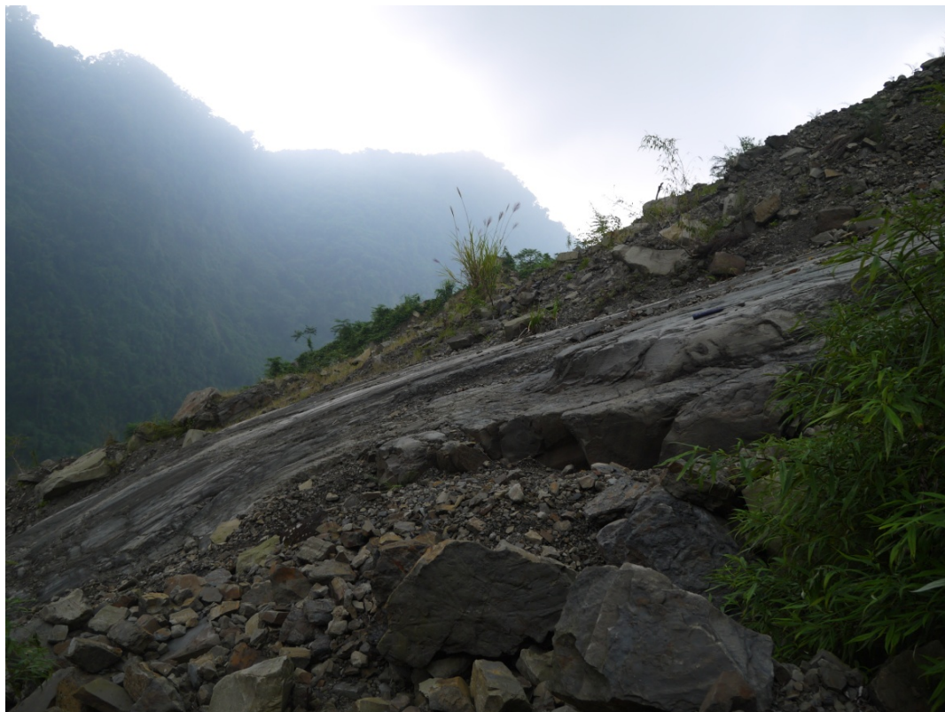
照片 3-2.3、瑪雅峻崩塌滑動面底部厚層砂岩，其砂岩有褶曲的現象，褶曲處發育許多裂隙。
