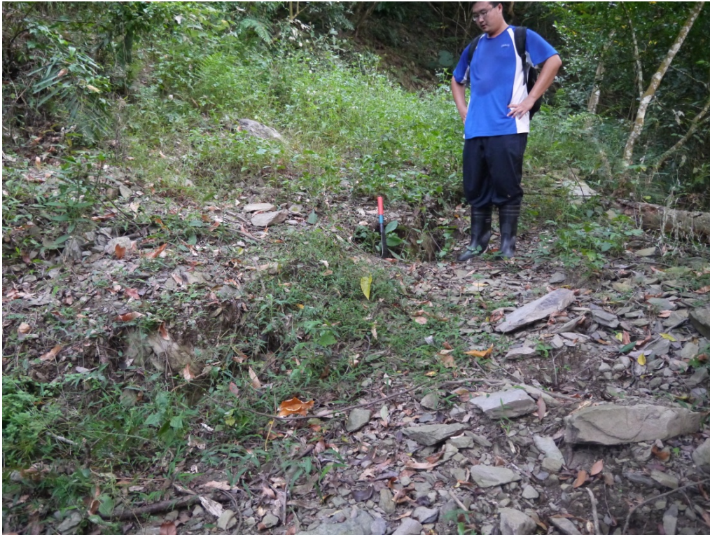
照片 3-4.16、調查點 9，目前坡面部分滑移，導致路面毀損。
