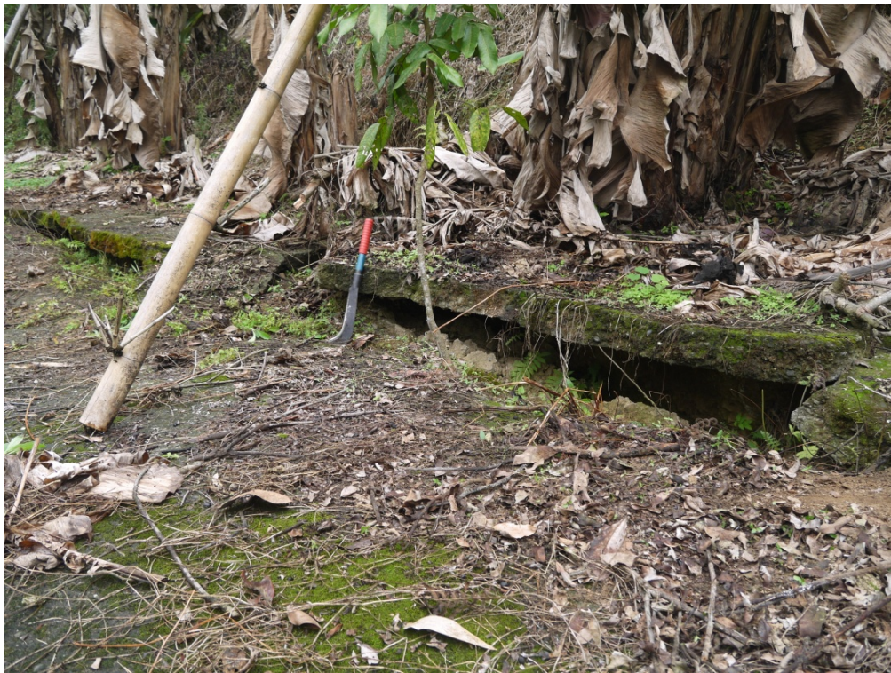
照片 3-4.70、調查點 9 位於坡腹道路，因邊坡滑移導致路面有 20 到 40 公分的落差。
