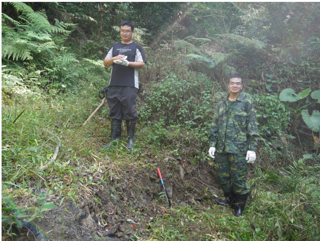
照片 3-4.17、調查點 11 位於坡面部分滑移，導致路面毀損，產生 60 公分不等的高差。
