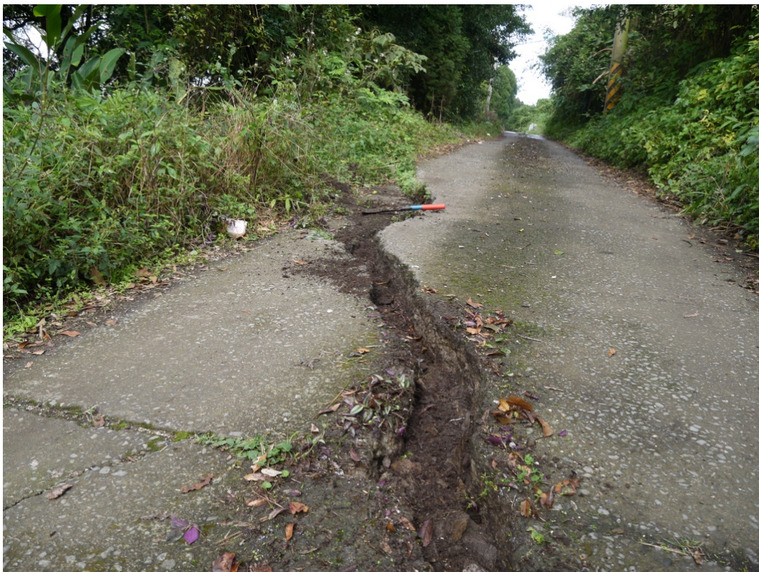
照片 3-4.35、調查點 G7-3 為道路破壞，路面拉張寬度 20 到 30 公分。
