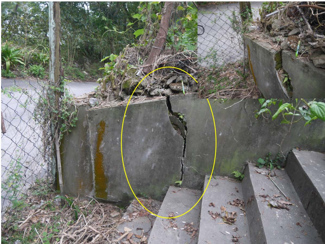
照片 3-4.84、調查點 6 建物圍牆和樓梯有拉張破壞，破壞裂隙有 10 到 15 公分寬。
