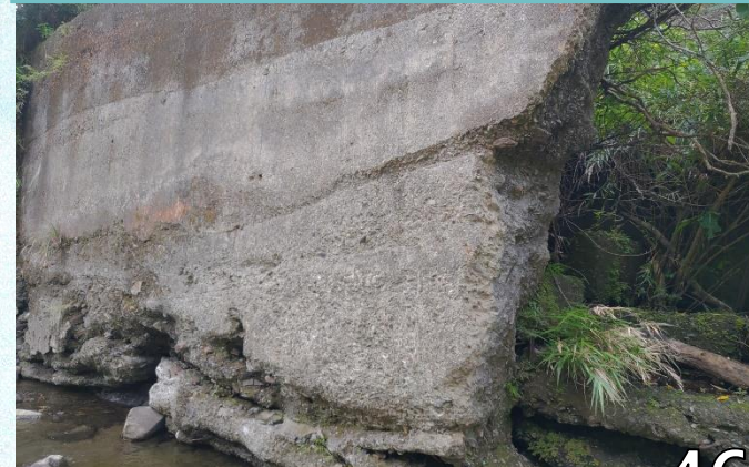
既有魚道結構老化
