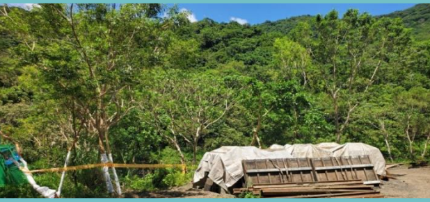
施工便道、土方堆置區及臨時置料區優先使用既有裸露地
