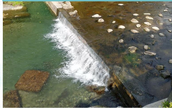
水墊下游刷深掏空
