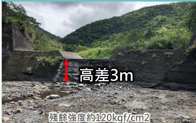
防砂壩結構老化
