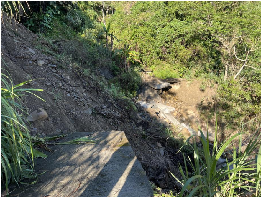
圖 6、通往表湖的道路崩塌情形
