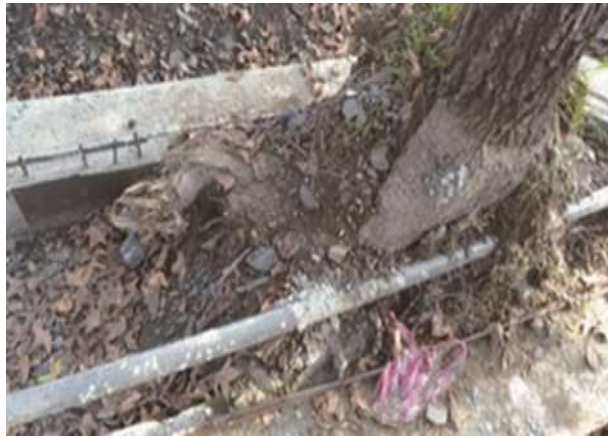
圖 5-15 工程造成都市樹木的機械性損傷。
