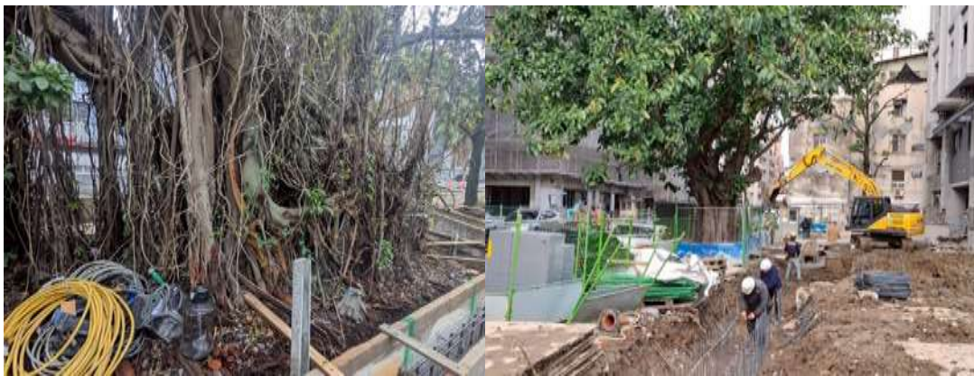
圖 13-5、樹木保護範圍內堆放機具、材料，導致樹木受傷，樹木保護範圍內不可進行挖掘埋設工程。
