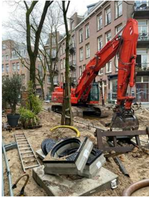
圖 13-10、施工過程因為機具輾壓，造成土壤結構改變。
