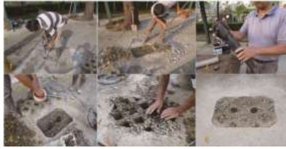
圖 9-17、破除硬鋪面的兩全其美對策；開鑿通透孔，改以造通透性鋪面取代。
