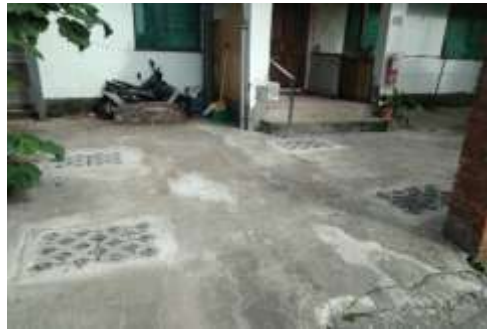
圖 9-15、人為使用的空間因敷設水泥硬鋪面及設施，導致樹木生長受滯，樹勢弱化，但為維持人員使用之可行，採取以開鑿通透孔道方式進行改善，滿足人的使用與樹木生長基本訴求。
