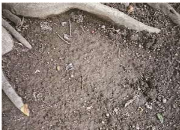
圖 1-56、表面土壤壓實是車輛或行人交通踏壓的常見現象
