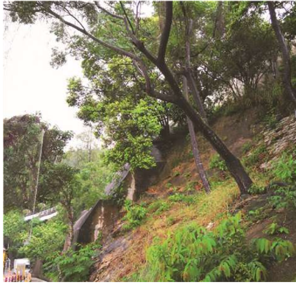
圖 1-54、斜坡上的樹木可能隨著斜坡的土壤和地形改變而倒塌。
