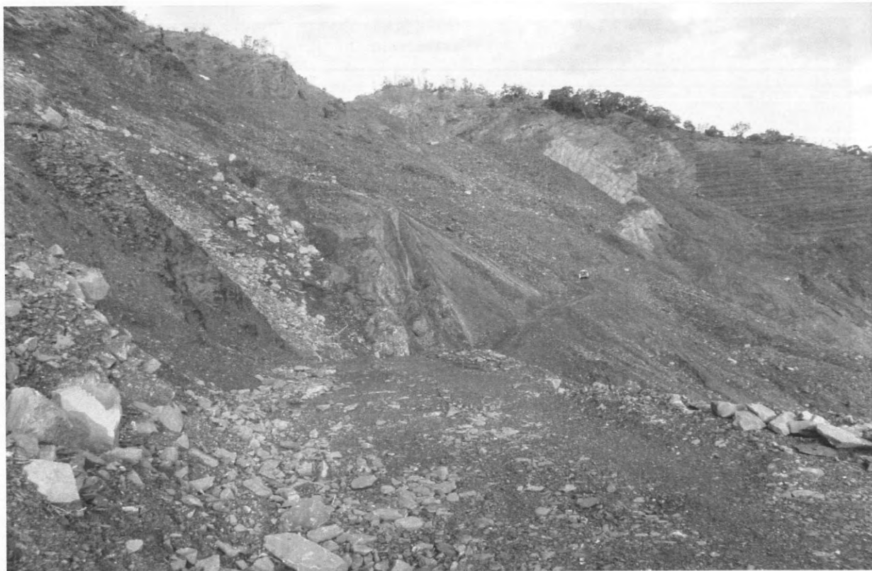
88風災45.5k崩塌處
