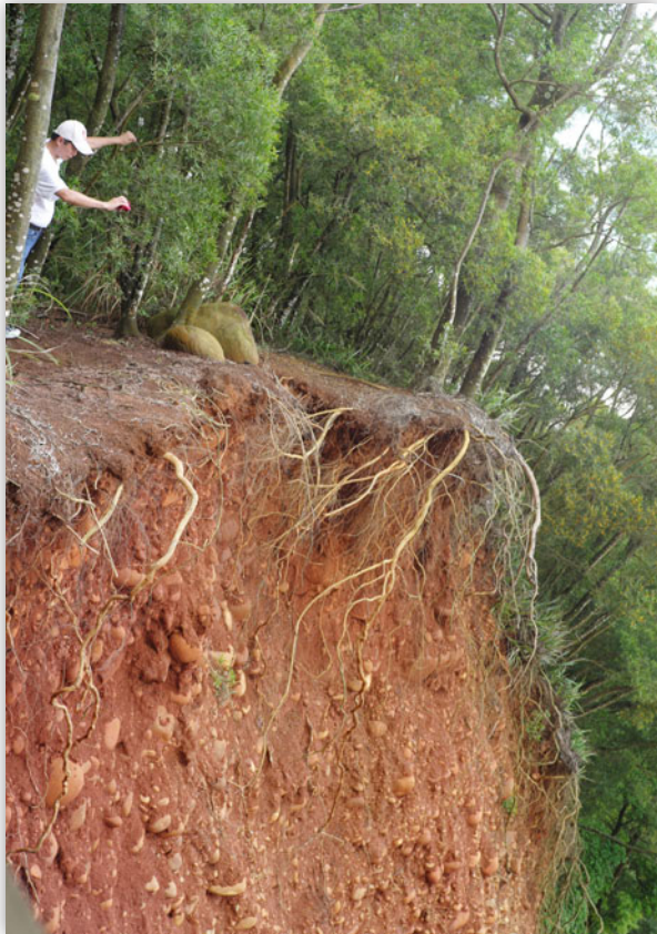
火炎山礫岩雖具有垂直壁立性，但因顆粒間孔隙大，逕流下滲快，進而破壞了受力的平衡導致崩落，形成邊坡快速後退的特性。根據觀察結果，火炎山邊坡年平均後退速率達 2 公尺以上
