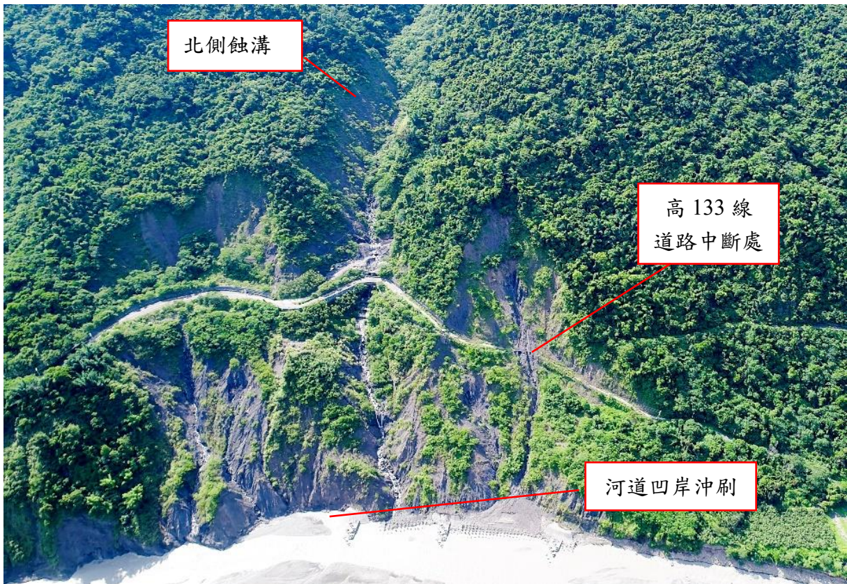
圖 4-12 北側蝕溝下游側及高 133 線道路邊坡狀況(106.7.14)
