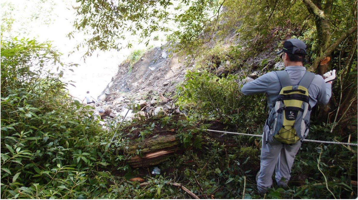
圖 3-107 下切至溪谷為崩積層不穩定邊坡
