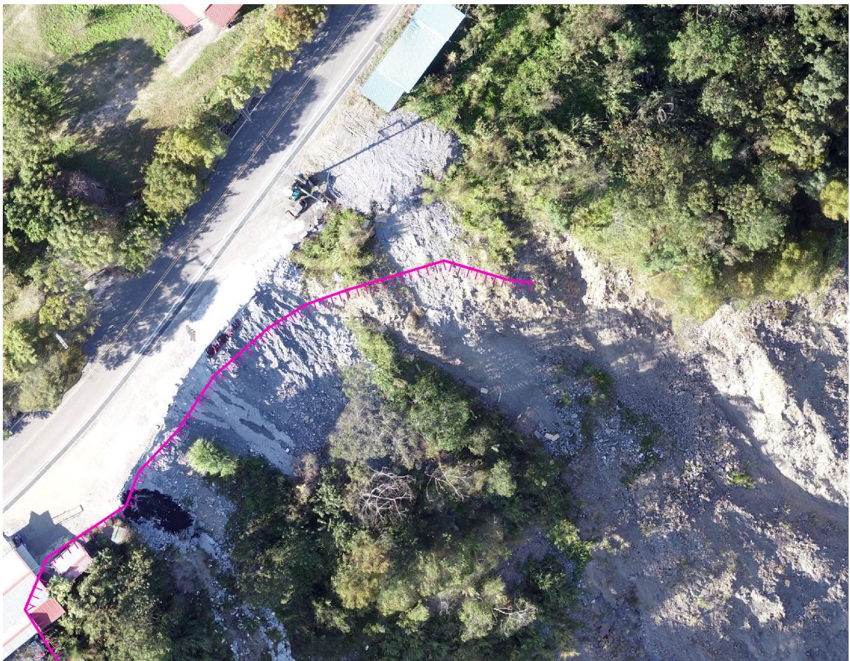
圖 3-11 奧萬大連外道路邊坡破壞(圖 3-8 方框位置)
