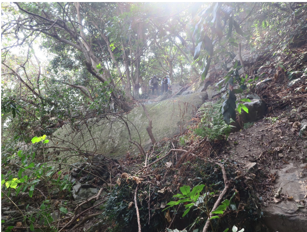
圖 6-14 高雄市-甲仙區-D044 上邊坡坡面殘留滑動後大岩塊
